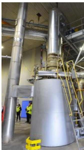
Le brûleur Cogebio est implanté au sommet de la chaudière de Soprema qui était verticale, photo FD
