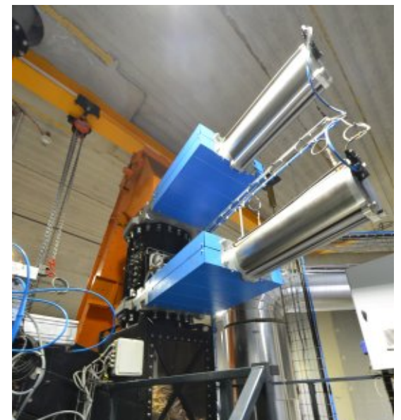
L'entrée du bois dans le gazéifieur se fait par un sas à deux guillottes, photo FD
